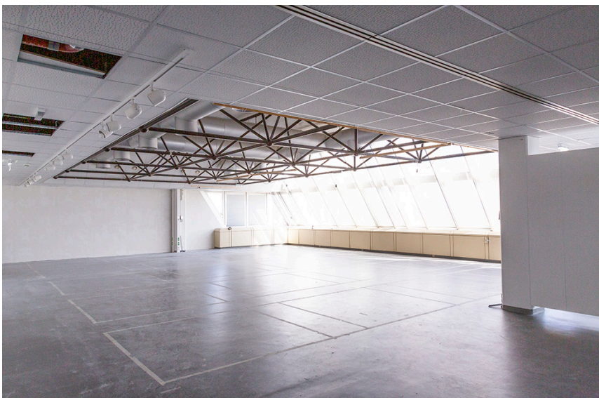
Freihandbibliothek - Scheinwerferleiste, Deckenverstrebungen
